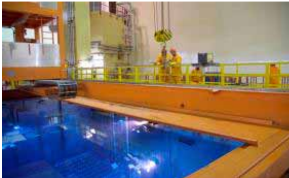
Piscina de armazenamento do combustível usado (Angra 2)
