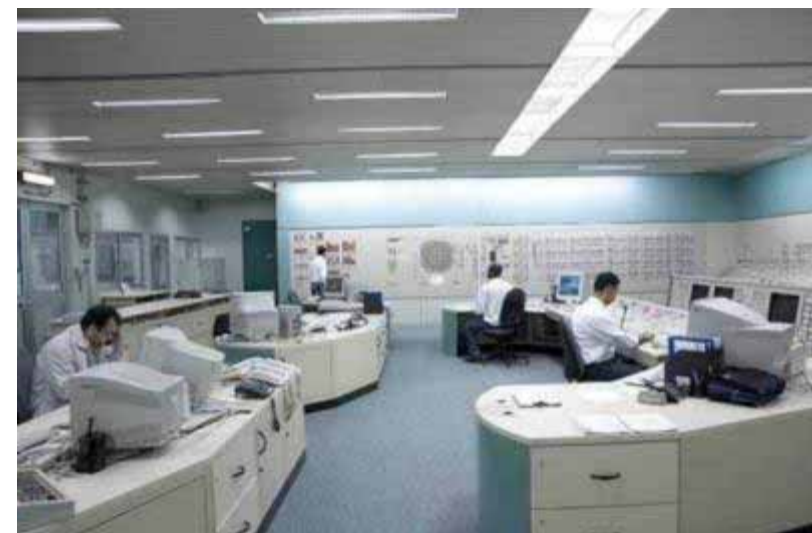
Sala de Controle – Angra 2
