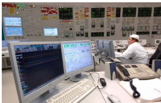
Sala de controle de um dos reatores da Central de Leningrad - (RBMK ou LGWR)
