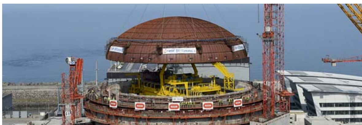
Flamanville - 3 (foto cortesia Edf)
